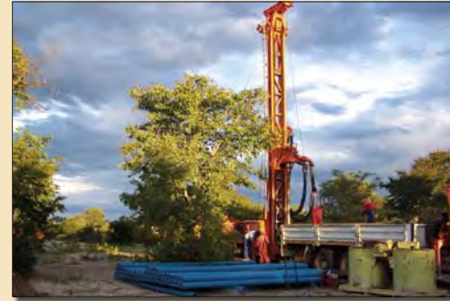
Bohrflöcher sind in vielen Gegenden Namibias für die Wasserversorgung unerlässlich.
